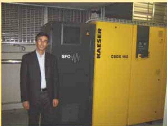
Stefan Imbach vor dem frequenzgeregelten Teillastkompressor
